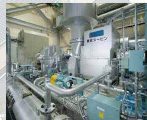
余熱利用設備
